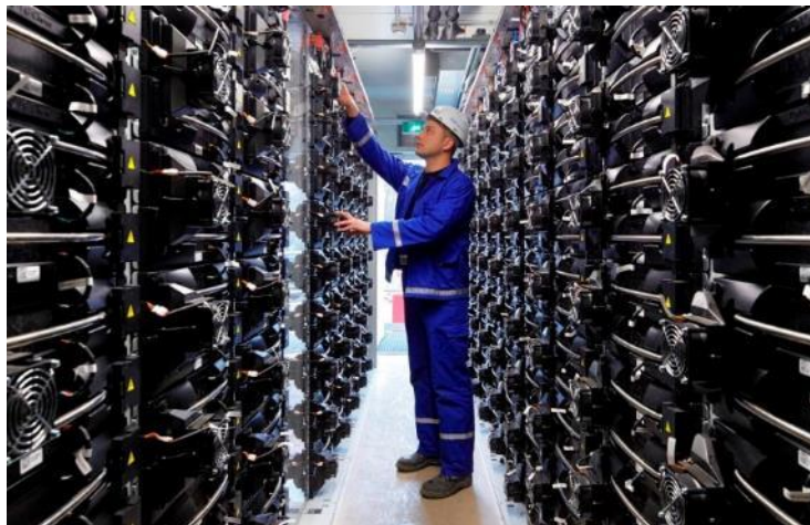
STEAG Großbatterie-Systeme: Ausgleich von Frequenzschwankungen im Stromnetz
