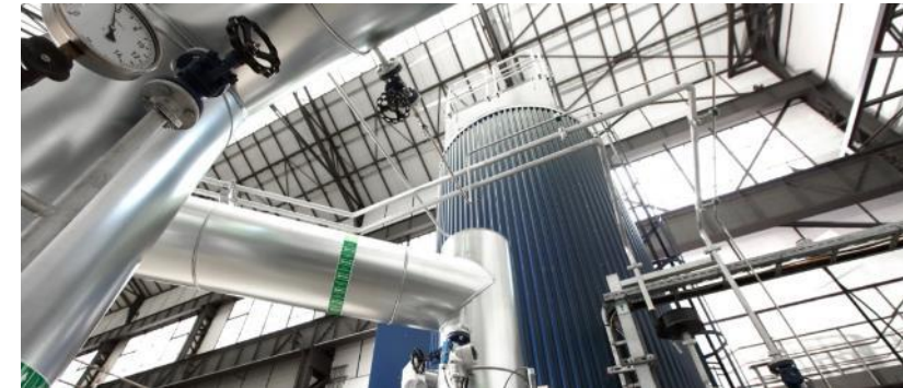
SINTEG-Projekt: Elektrodenkessel am Standort VK-Fenne
